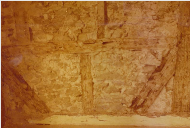
Freigelegte ehemalige Außenwand zw. Mittel- und SW-Eckzimmer mit verzierten Balken wie an der Ostseite des Hauses
